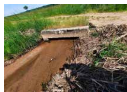
Figure 2 : exemple d'ouvrage fréquemment obstrué par les branchages et les sables (photo : SINBIO SCOP, 2022)
